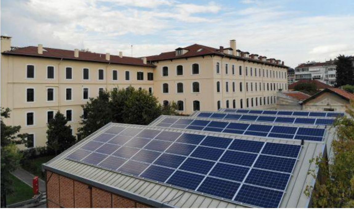
Şekil 8. İstanbul Saint-Joseph Lisesi Güneş Enerjisi Paneli Uygulaması Kurulu güç: 33 kWp, yıllık tasarruf; %12 (kaynak: enerjidünyasi.com)
