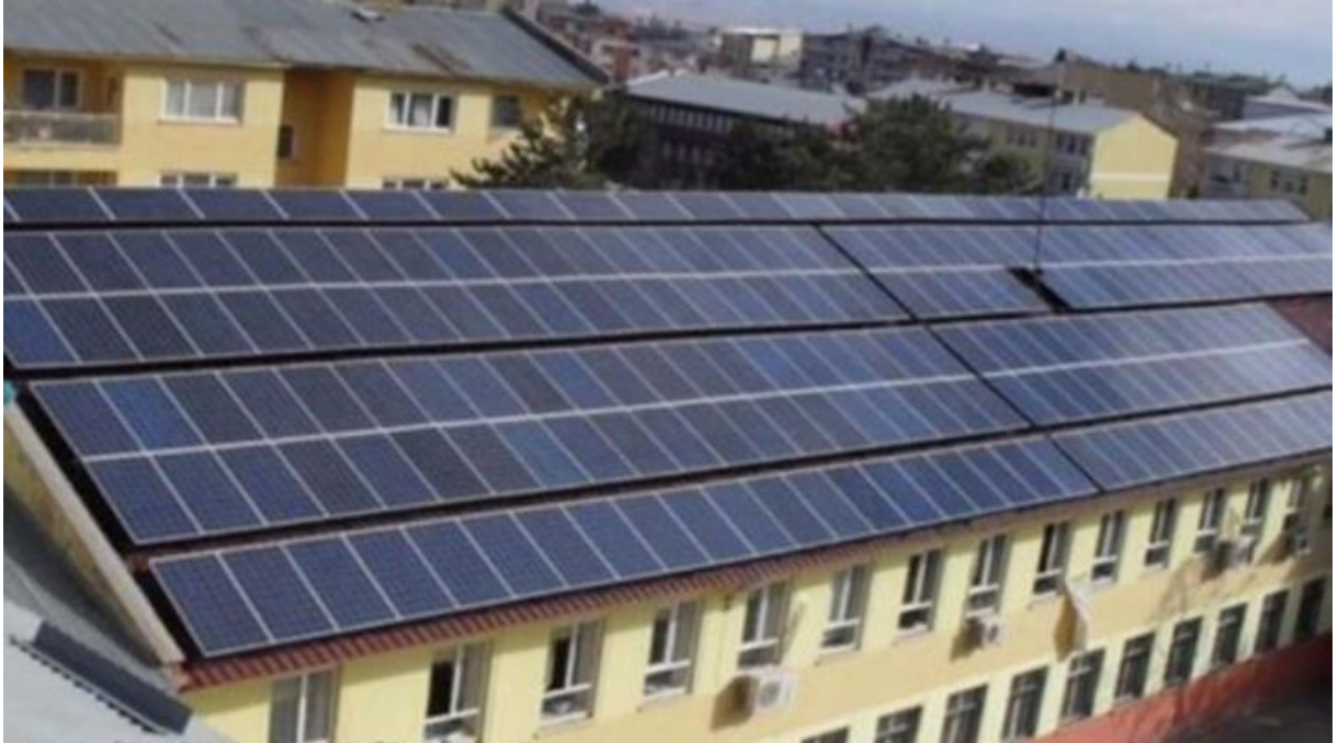
Şekil 7. Muş Mesleki ve Teknik Anadolu Lisesi Güneş Enerjisi Paneli Uygulaması
